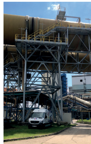
Měření v Teplárně Trmice (foto: Lukáš Pilař)
