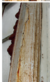
Trhlinami poškozené litinové sloupky
