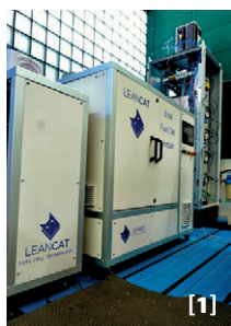
[1] Skříň elektrického generátoru s vodíkovým palivovým článkem a baterií.
