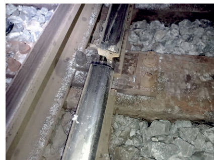
Lom jazyka výhybky na Kladně
